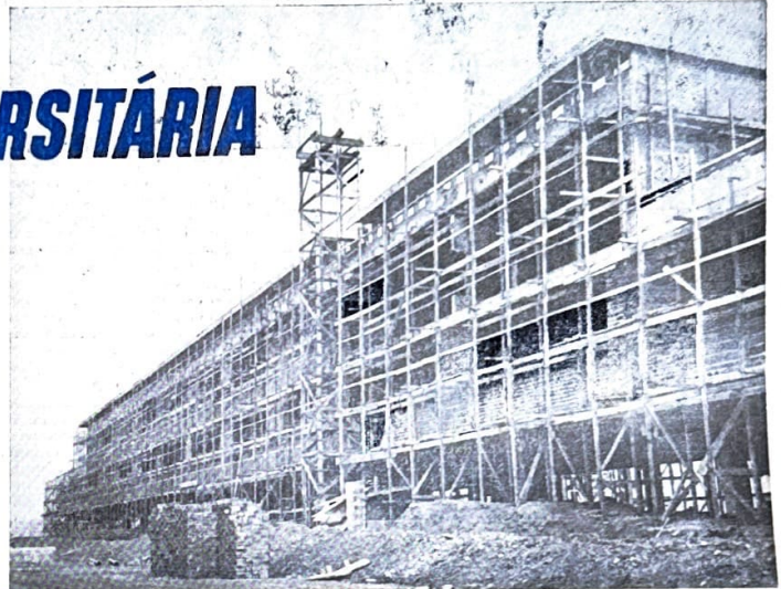
Escola Politécnica na Cidade Universitária: Aqui se vêem as obras do pavilhão que abrigará o Departamento de Maternidade.
